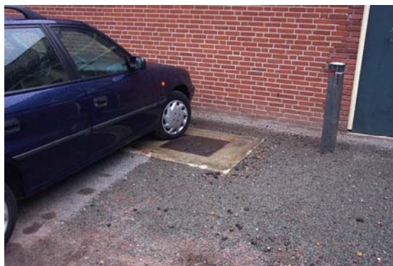
Foto 4. Deze pompput is niet beschermd tegen invloeden van buitenaf
